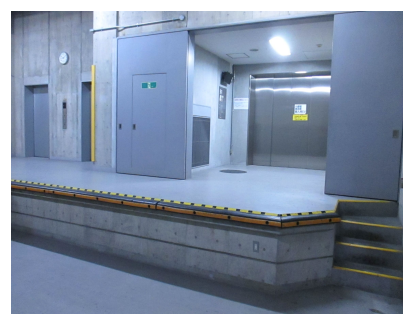
搬入EVとプラットフォーム
